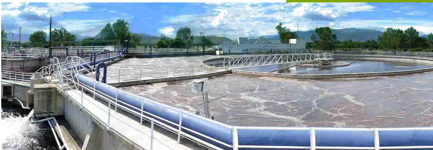
Planta de Tratamiento Xoxocotlán, Oaxaca, 600 lps.
