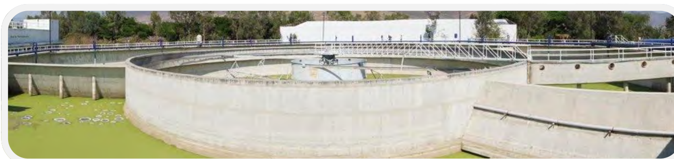
Rehabilitación, Operación y Mantenimiento - Xoxocotlán, Oax. 600 lps.
